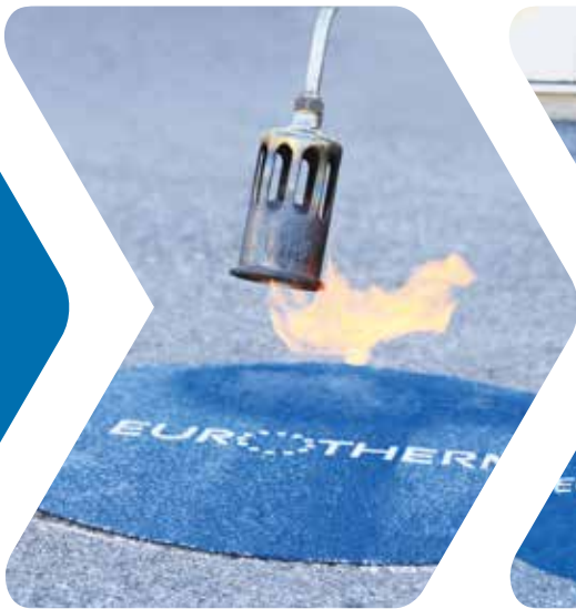
EUROTHERM mit dem Gasbrenner ganzflächig erhitzen – bis zur Blasenbildung an der Oberfläche.
